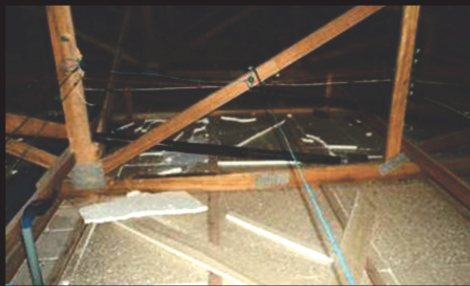
Instalações elétricas precárias, fora de qualquer padrão de segurança
